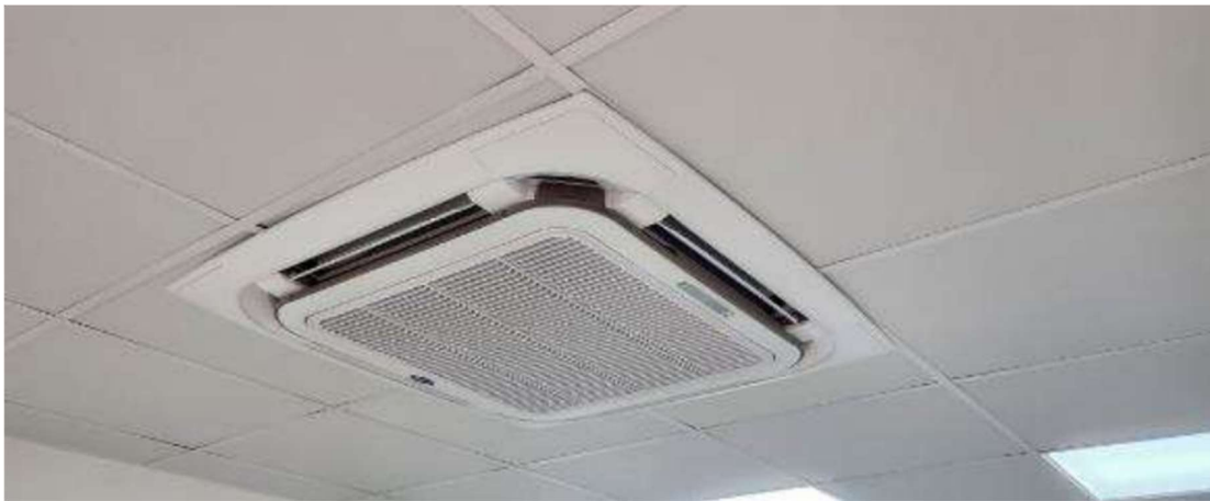
Image 9. Exemple de climatiseur intégré
